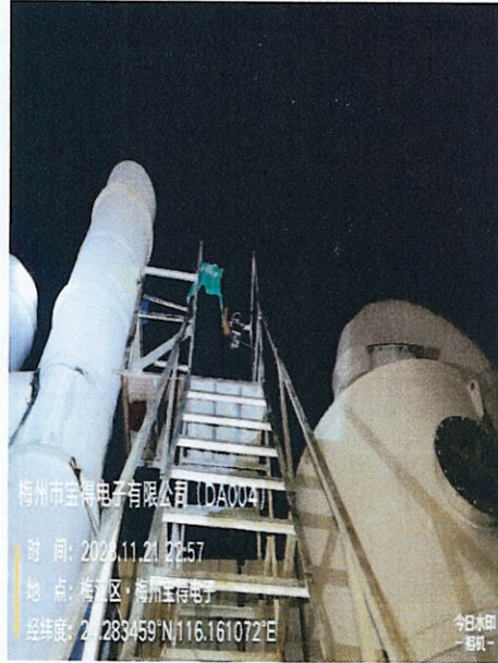
蚀刻废气排放口 DA004
