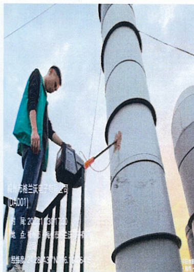
碱性废气排放口 DA001
