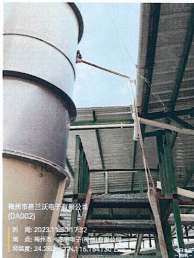
电镀废气排放口 DA002
